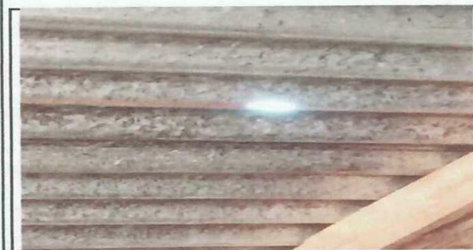
Foto 5: SE CAMBIARÁN TODAS LAS LÁMINAS, YA QUE SE ENCUENTRAN EN MAL ESTADO.
